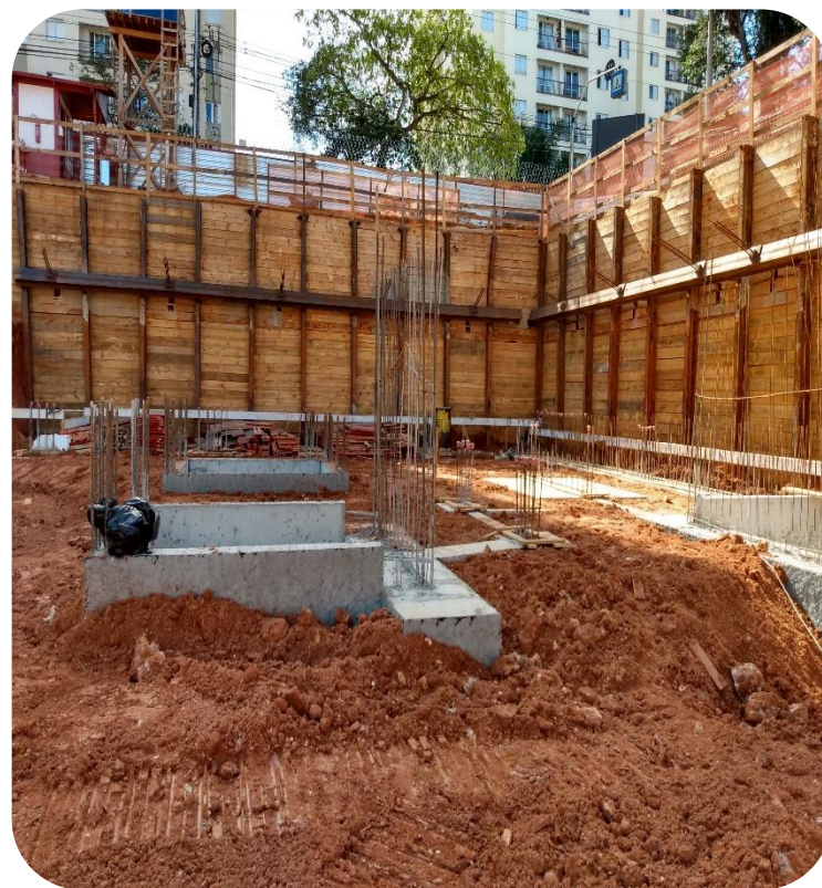
Blocos de fundação com arranques de pilares para execução da primeira laje .
